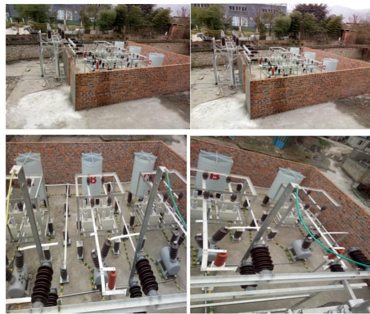
35KV侧 1500Kvar (主负荷出线采样, 满足夜间重负荷无功)
